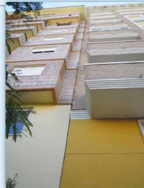
Bloque de viviendas ubicado en Elda (Alicante), que mediante un recalce con micropilotes ha resuelto su problema de separación.
